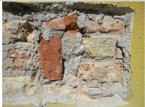
Particolare della conformazione costruttiva della muratura, in cui osservabile lo spessore e l'andamento dei letti di malta.
