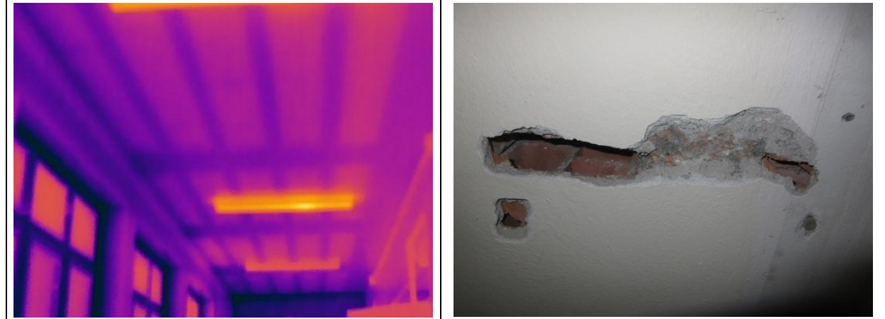
Analisi all'infrarosso in cui osservabile la scansione dell'orditura portante del solaio. Demolizione puntuale dell'intradosso del solaio, disposta al fine di consentire il rilievo della conformazione costruttiva.
