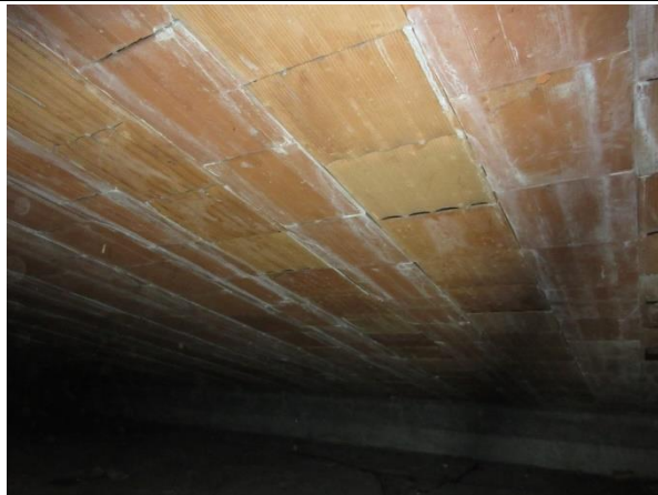
Vista di insieme dell'intradosso del padiglione di copertura in cui osservabile la direzione dell'orditura portante.
