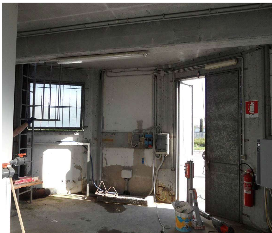
Figura 5 – Interno della sala macchine alla base
